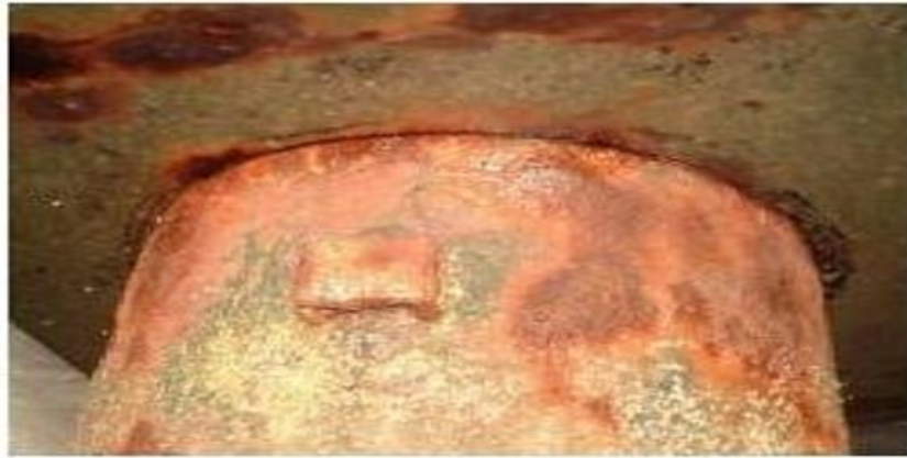
Figure 2.6: corrosion sur la tête de pieu [14].
