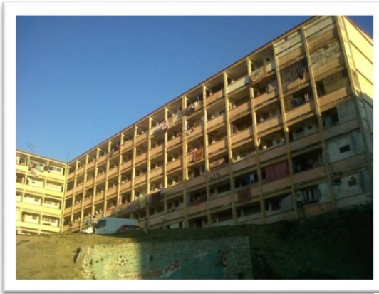
Figure 32: Façade en état dégradé et mal entretenu Source : Auteur
