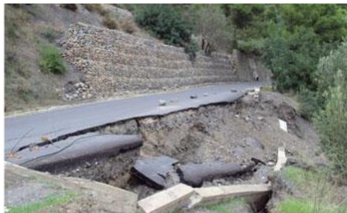
Figure I.14: Glissement de terrain à Darguina Ait Smaïl [8]
