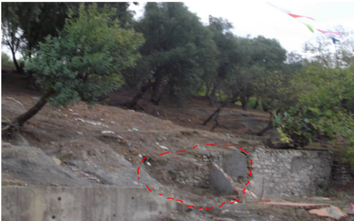
Figure I-4 : Rupture du mur de soutènement [16].
