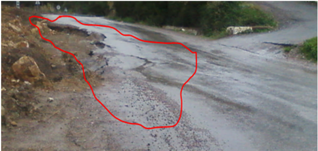
Figure I-5.a : Affaissement et fissures [16].
