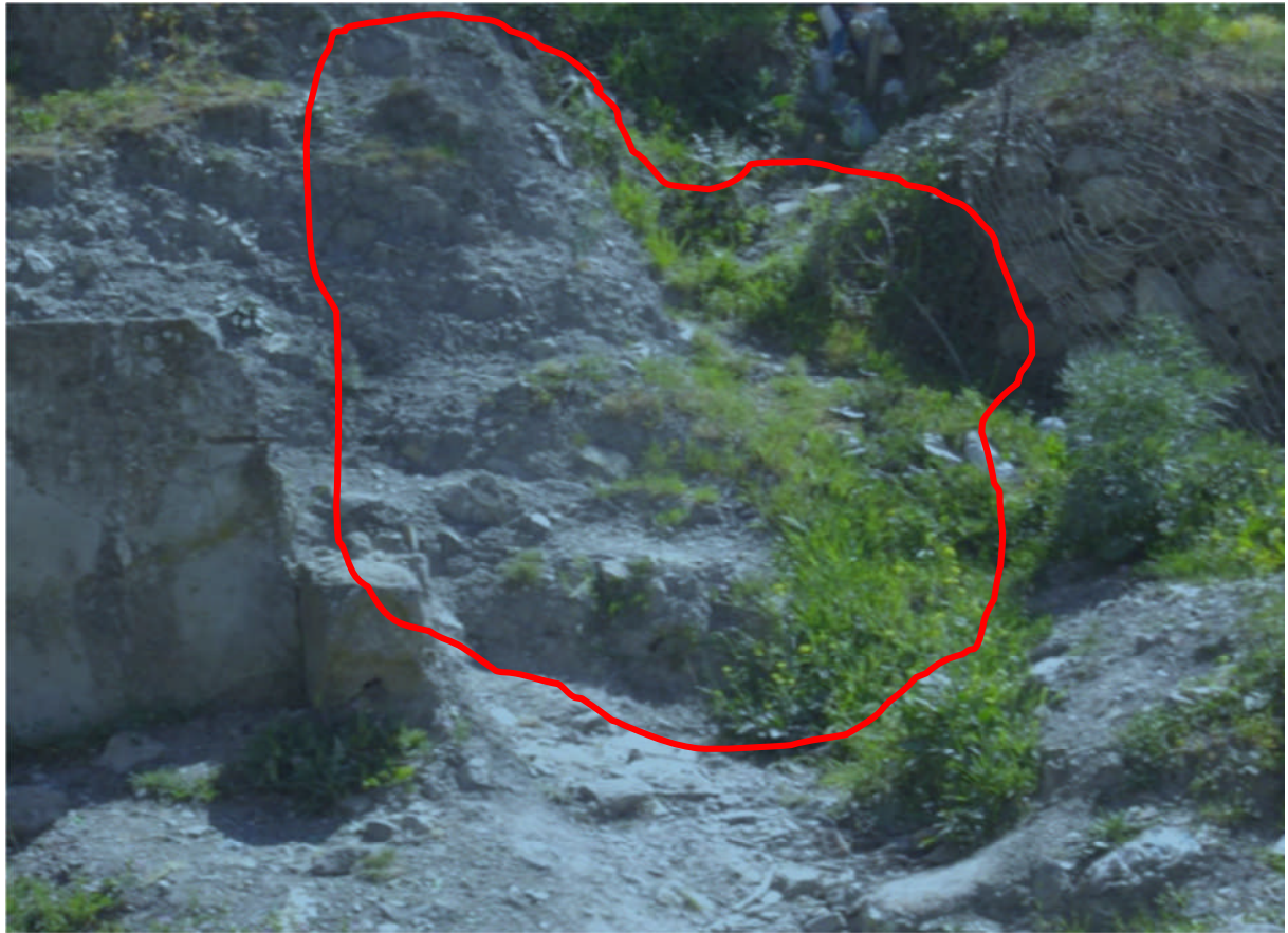
Figure I-6.b : Création d'une ravine et rupture de mur de soutènement [16].
