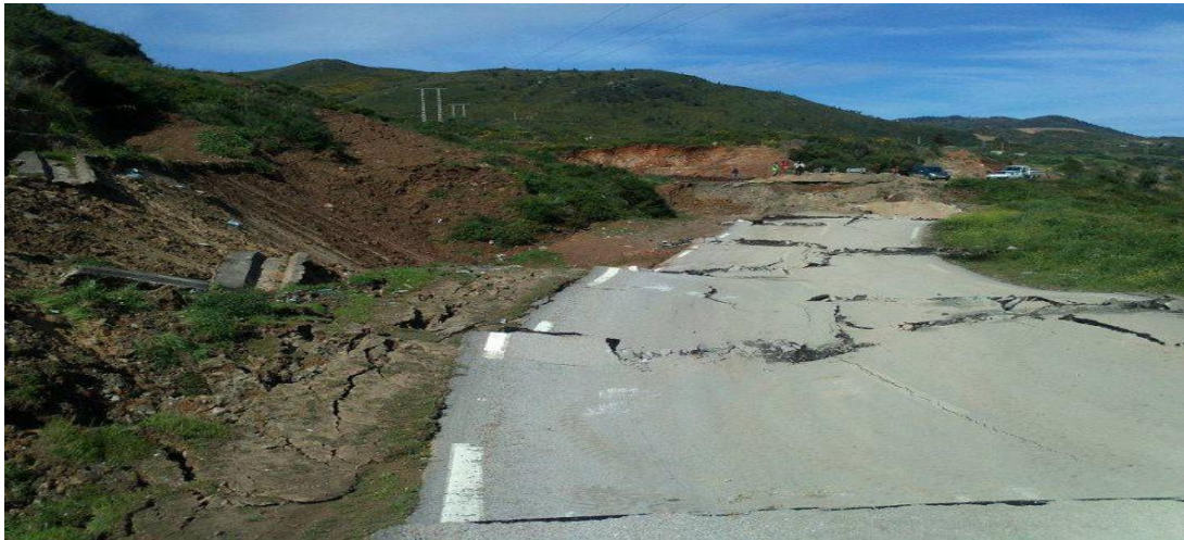
Figure 1-7 Affaissement sur la route nationale n° 24, reliant Bejaia à Tizi-Ouzou (au village de Tighrent)
