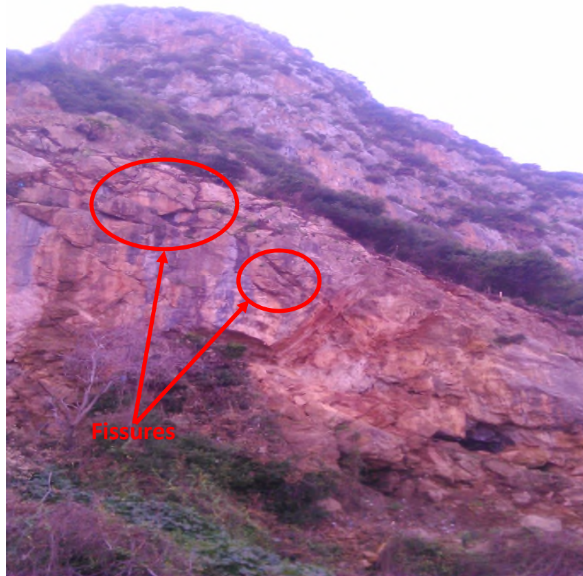
Figure I. 1. Vue d'un talus rocheux fissuré, situé à AOKAS.
