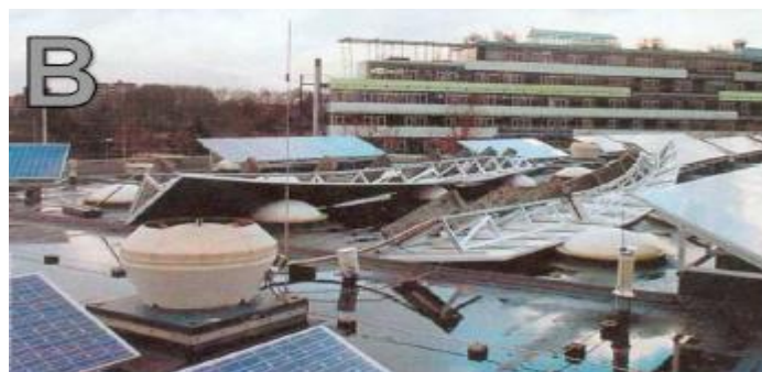
Figure III.6 : B- Structure PV arrachée par le vent.
