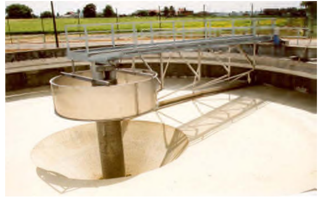
Figure I.2 : Décanteur primaire avec pont racleur entraînement périphérique.
