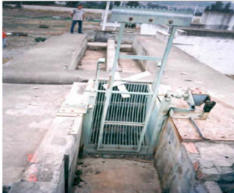
Figure III.5: vue générale sur le dessableur
