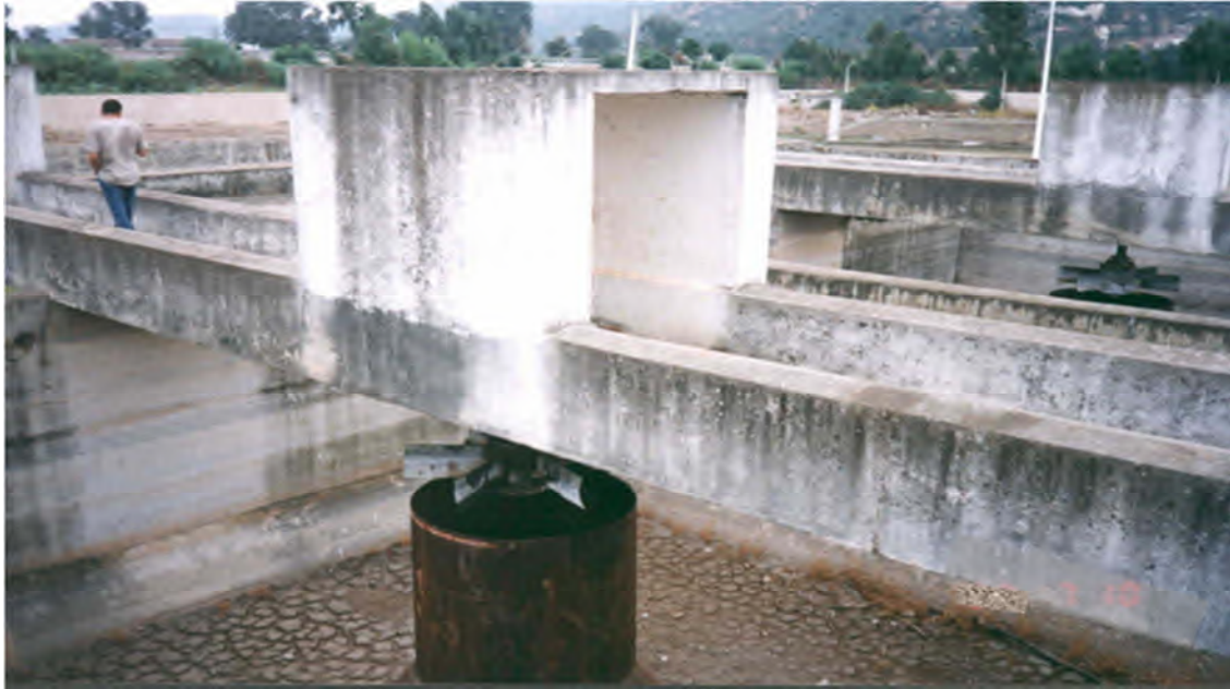
Figure III.6 : Vue rapproché sur un bassin d'aération et de décantation
