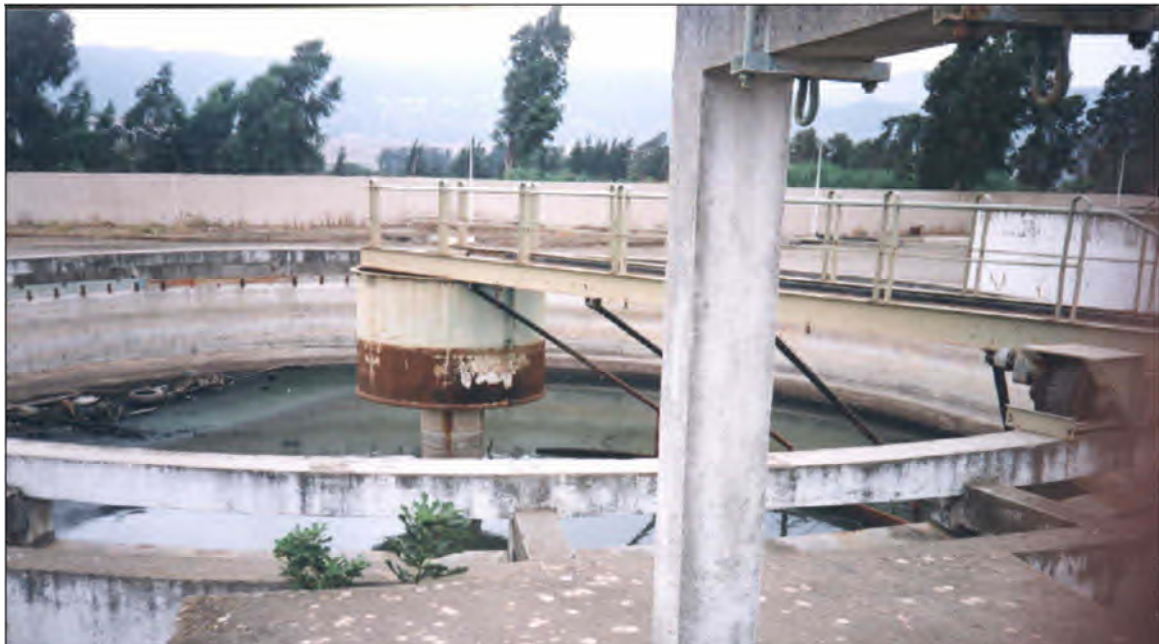
Figure III.7: Vue rapprochée sur le décanteur secondaire
