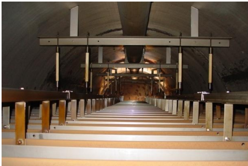
Figure .IV.1. Les électrodes à l'intérieur du dessaleur
