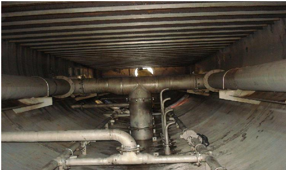
figure.I.8. Vue intérieur d'un dessaleur électrostatique
