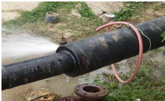
Image 5 : Fuite au niveau de la vanne de vidange de SR1.
