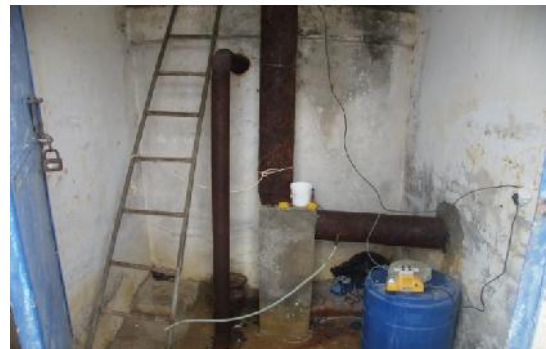
Image 6 : chambre de pompe de SR1.
