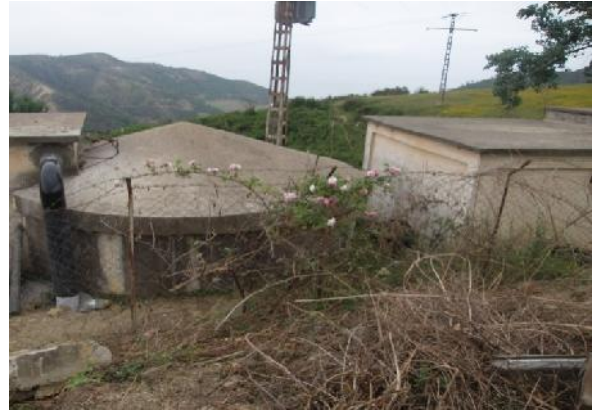
Image 2 : station de reprise1.
