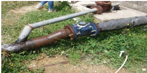
Image 3 : les vannes du réservoir 1000m 3 .
