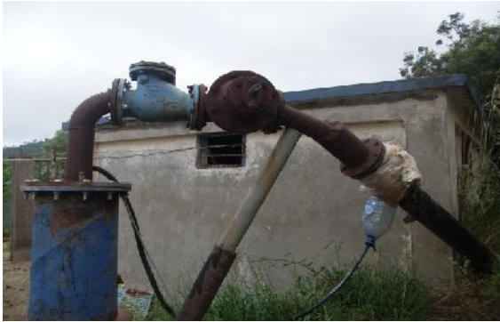
Image 7 : vannes à la station de reprise2.
