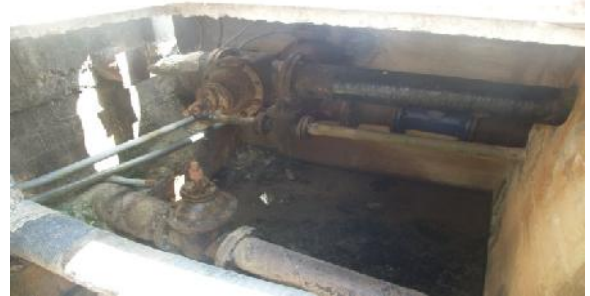
Image4 : chambre de vannes du réservoir 1000m 3 .
