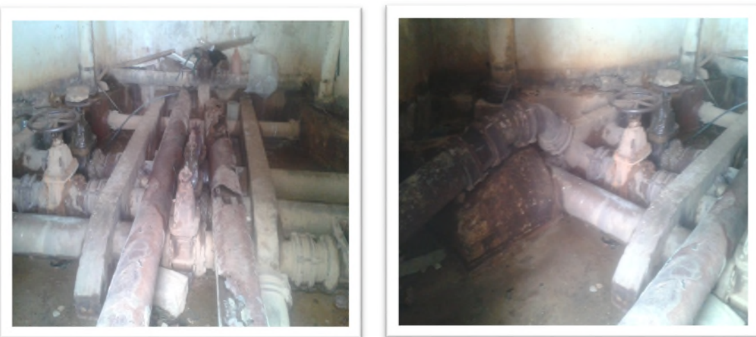
Image (III.7) : Etat avancé d'oxydation et cassure des conduites
