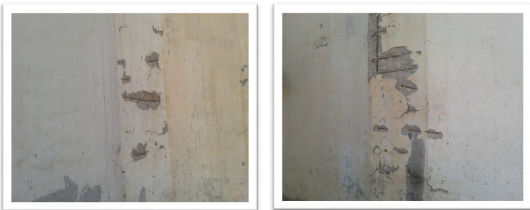
Image (III.5) : Dégradation du béton armé et fissuration des parois
