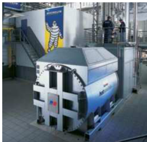
Figure 1.5 : MCFC installé dans une usine Michelin en Allemagne
