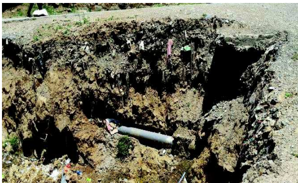
Figure (III-2) : Conduite apparente due à l'affaissement des terres
