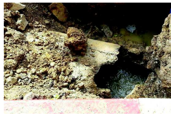
Figure (III-5) : Conduite cassée
