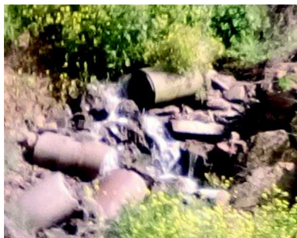
Figure (III-13): Conduites d'un Rejet décalées
