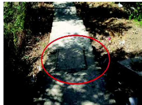
Figure (III-9): Regard enseveli à cause du bitumage des voies
