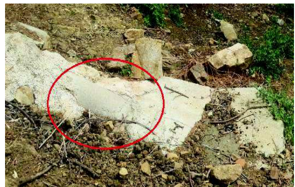
Figure (III-3) : Affleurement de conduite (érosion)
