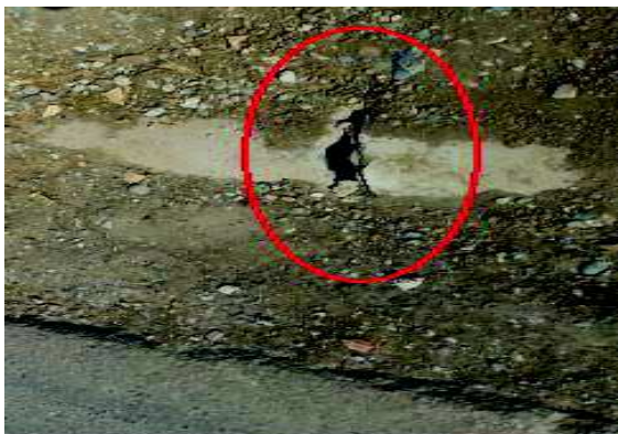
Figure (III-4) : Déboitement des joints des conduites
