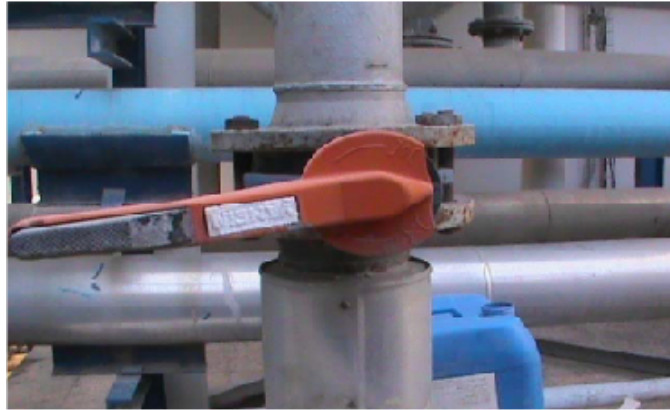
FIGURE 1.4 – la vanne manuelle
