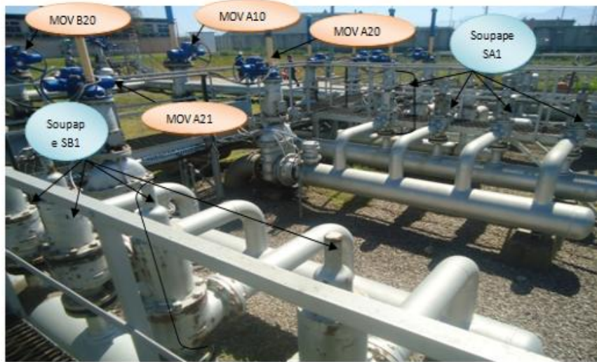
Figure I.4 : Constitution de la première section de la batterie des soupapes
