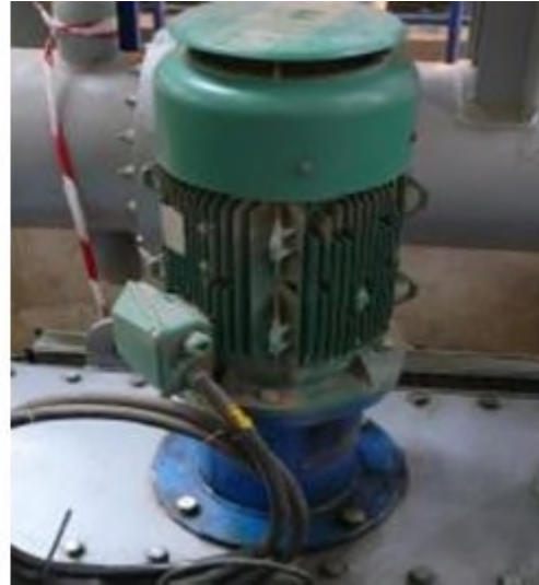
Figure II.5 : Pompe d'évacuation des calories
