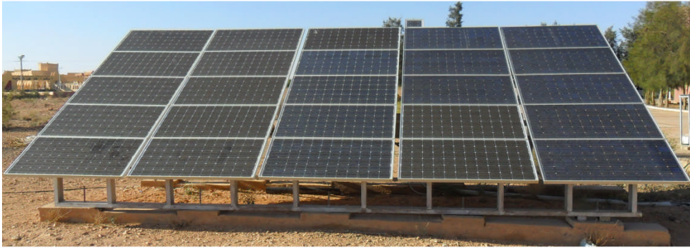
Figure I.25 : Panneau solaire -Site de Ghardaïa (URAER)
