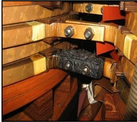
Fig. 4.3: Point chaud sur connexion boulonnée
