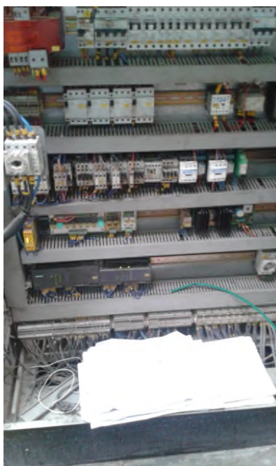
Figure IV.2 : Armoire électrique de la machine.
