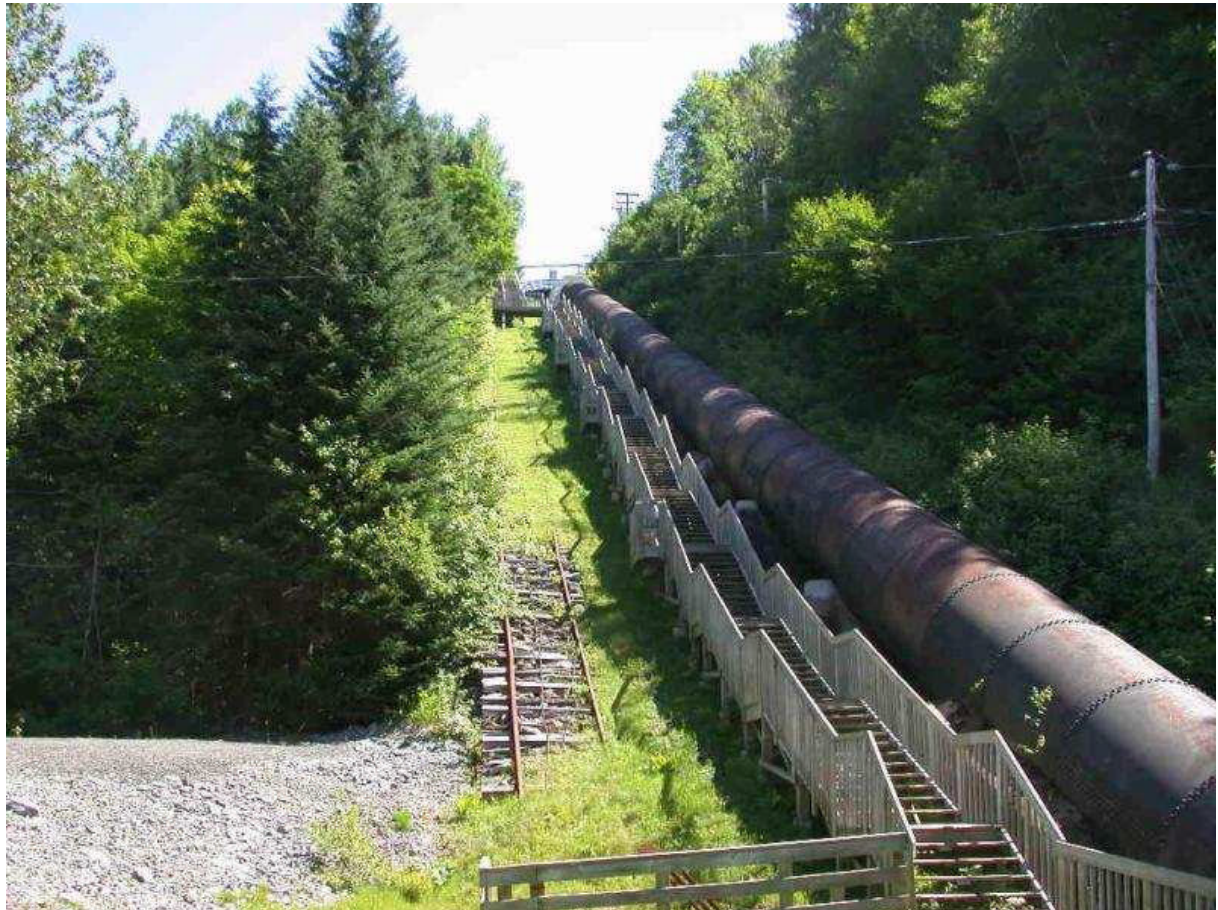
Figure 1.7 : Exemple de conduite forcée aérienne
