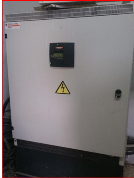
Figure III.5: Vue de la batterie de compensation du site.
