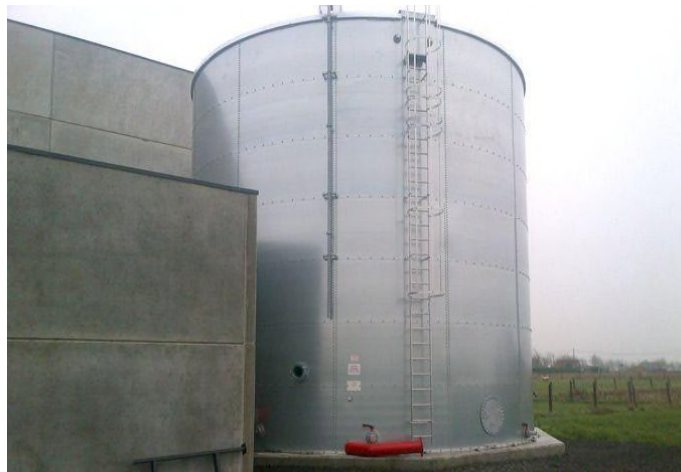
Figure I.25 : Réservoir de stockage d'eau.
