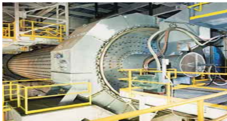
Figure III.4 : broyeur à boulets.
