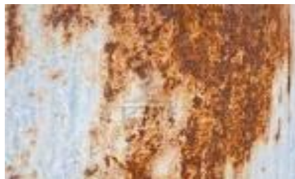
Figure N°4: Le phénomène de la corrosion
