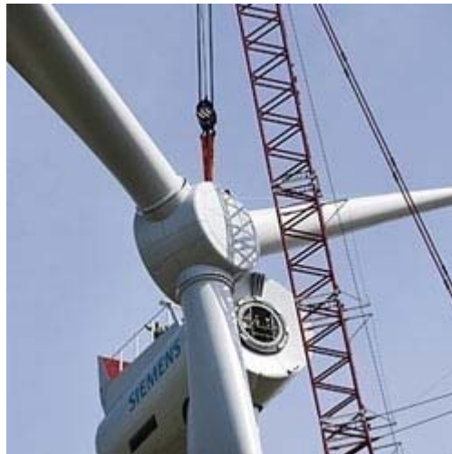
Fig.I.7 : Prototype de turbine éolienne SWT-6.0 à Hovsore [17]
