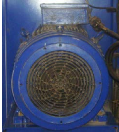
Figure. II.17-Moteur entrainant le ventilateur
