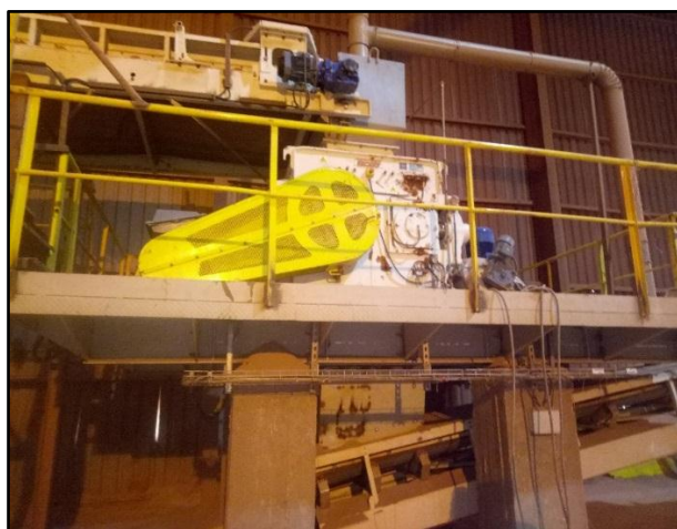
Figure.II.4 Photo montrant Dés agrégateur (briqueterie tamadnine Adrar).
