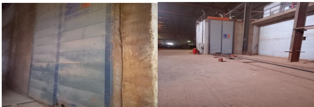
Figure.II.10. Photo montrant Séchoir (briqueterie tamadnine Adrar).
