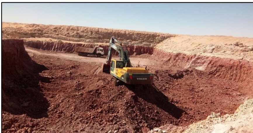
Figure.II.3. Photo montrant l'extraction des argiles à l'aide de la pelle hydraulique (carrière d'Adrar nord).
