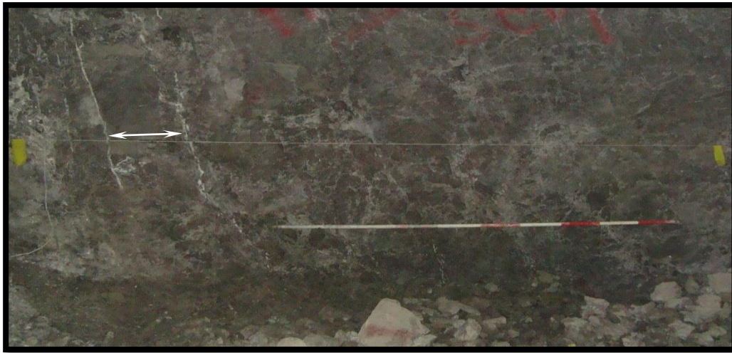
Figure I.13: Espacement entre deux joints apparents dans le massif de la mine de Chaâbet El Hamra [Photo prise en 2018 Ain Azel-Sétif]
