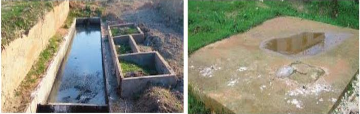
Figure I.7: L'état des bassins de décantations et les installations autonome.
