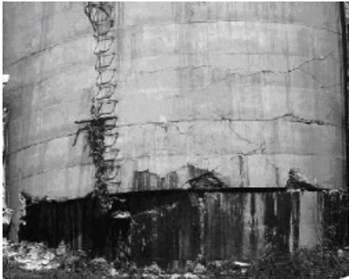
Figure III.4: La détérioration des silos-tours en béton due à l'attaque des acides d'ensilage. (Photo offerte par : Thomas P. Rylett Ltd., ingénieur-conseil en structures).
