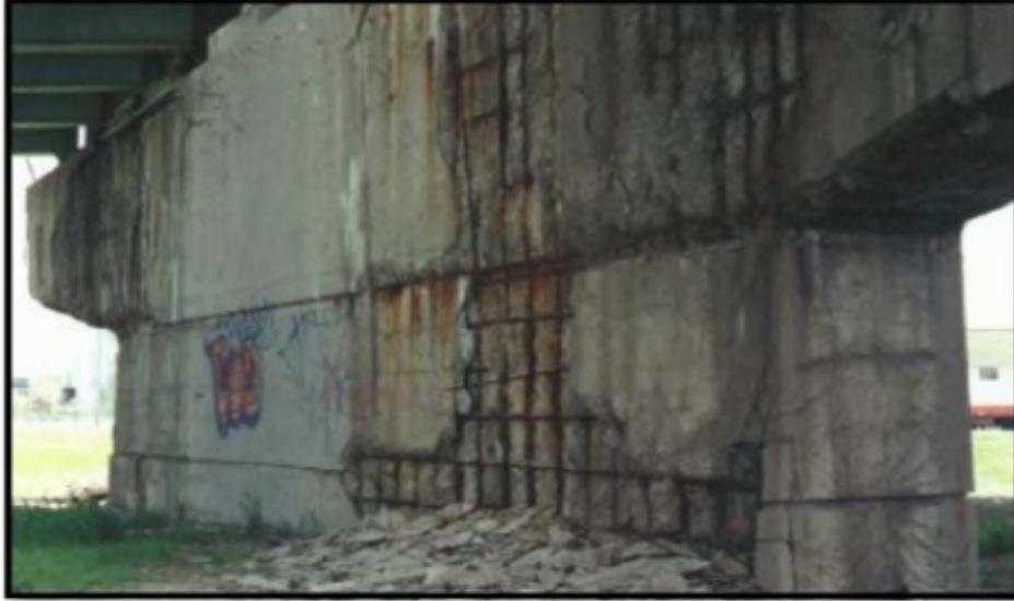
Figure III.6: Agression du béton par activité des chlorures.
