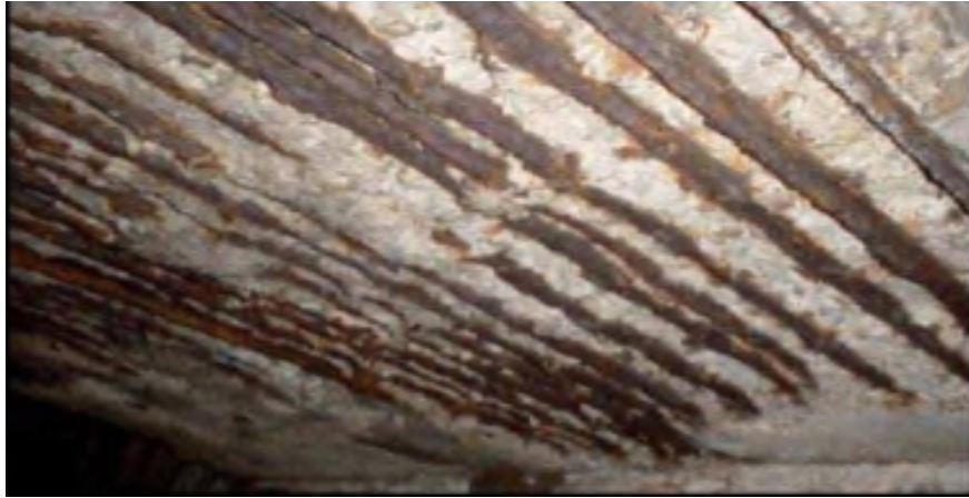
Figure III.5 : Les attaques des sulfates sur les armatures et le béton.
