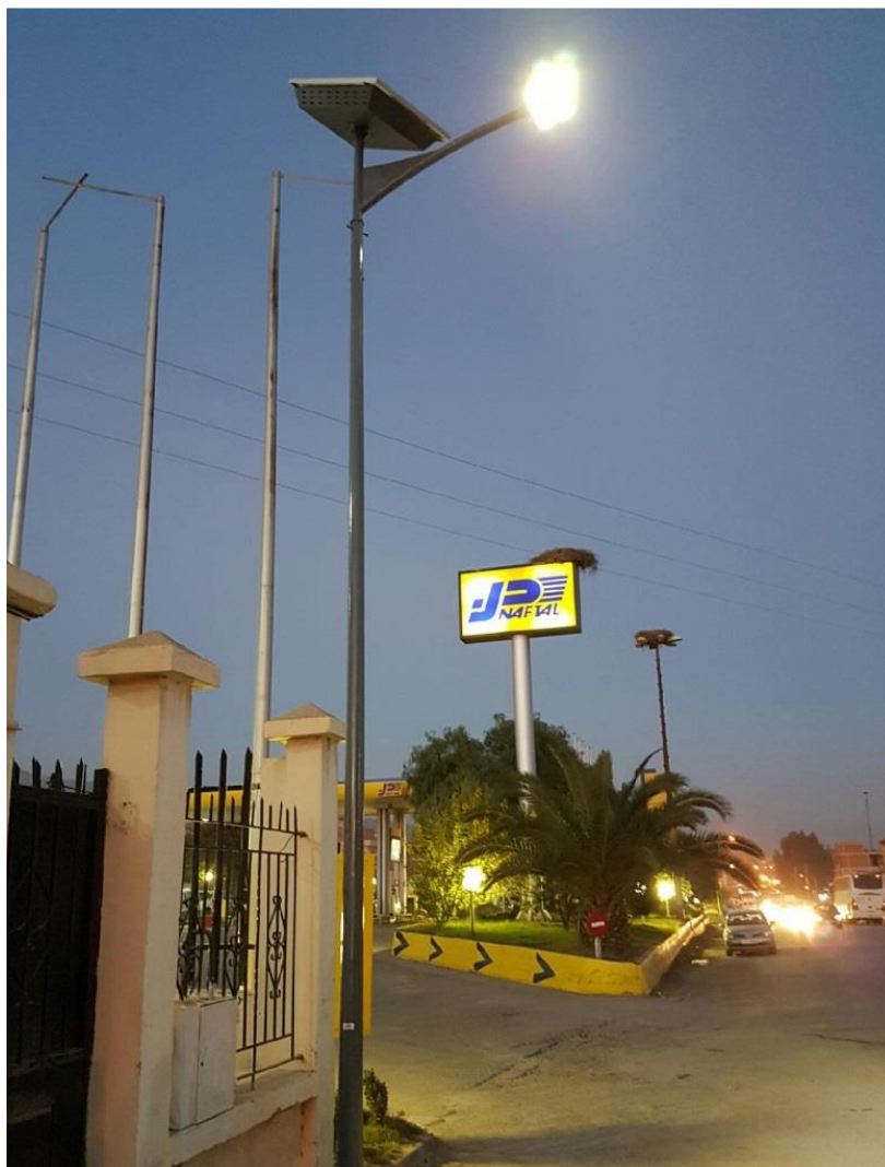
Figure III.1 : Éclairage public solaire àLED (installation W. B ęa ñ, Juillet 2016)
