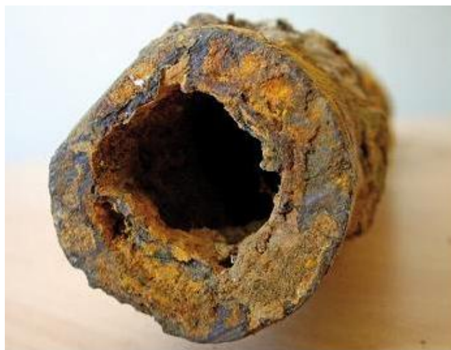
Figure I.7 : Vieillessement des canalisations (TARFAYA, 2012)
