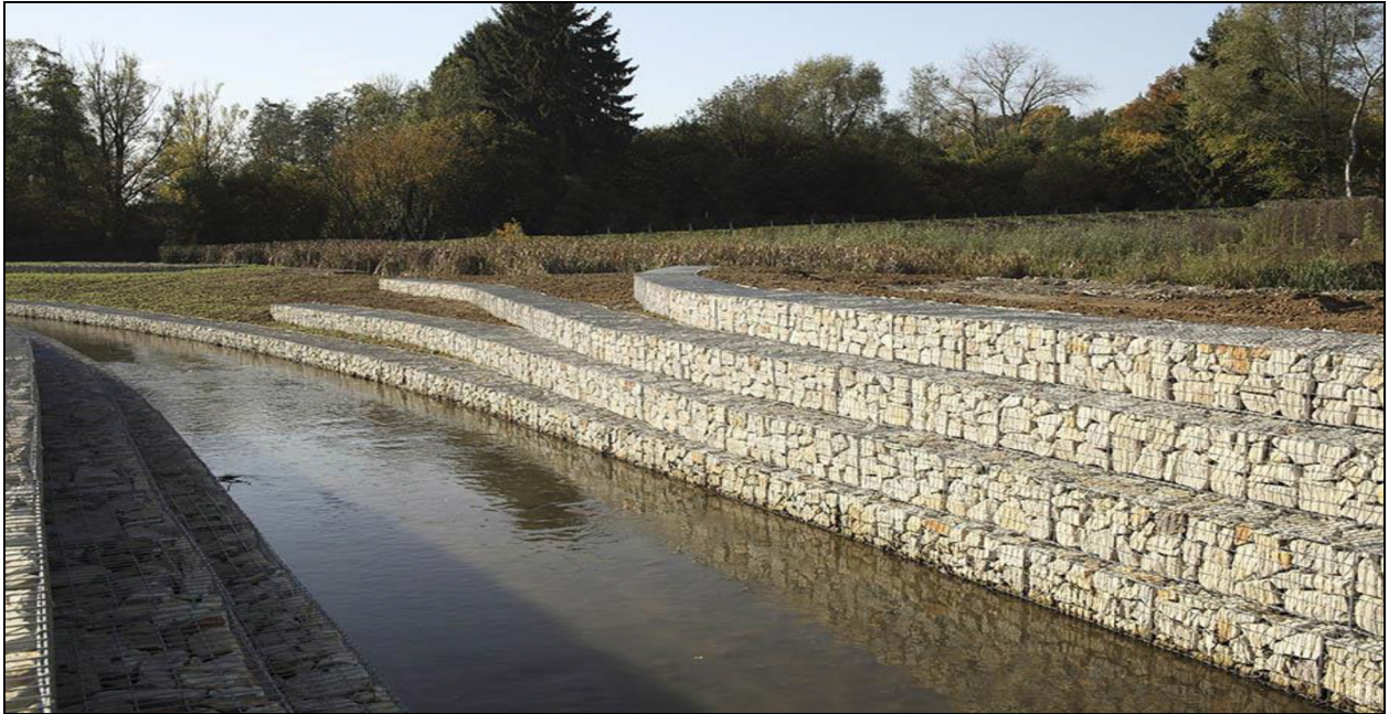
Figure V.5 : Image illustrant une protection des berges par gabionnage
