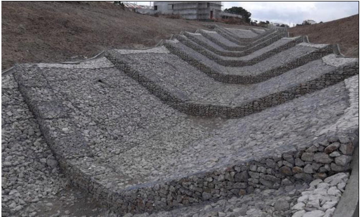
Figure V.7 : Ouvrage de protection des berges par Matelas-gabions
