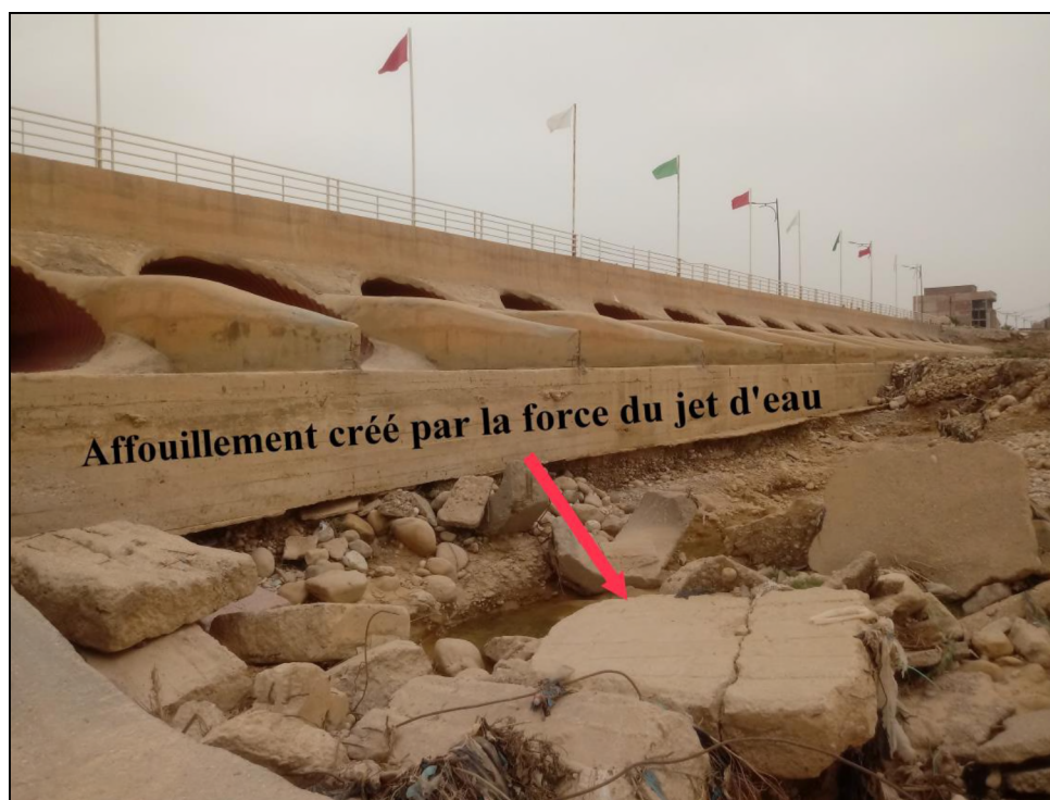
Figure IV.5 : Image représentant un affouillement créé par la force du jet d'eau
