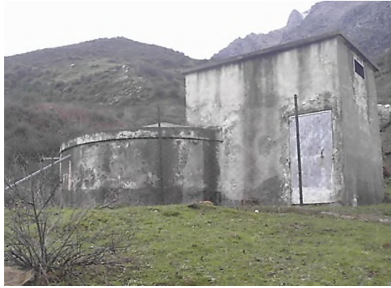
Figure.II.6 : L'extérieur du réservoir de 50 m 3
