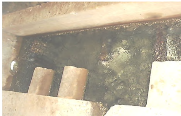
Figure.II.3 : Bassin de mise en charge captage non protégée
