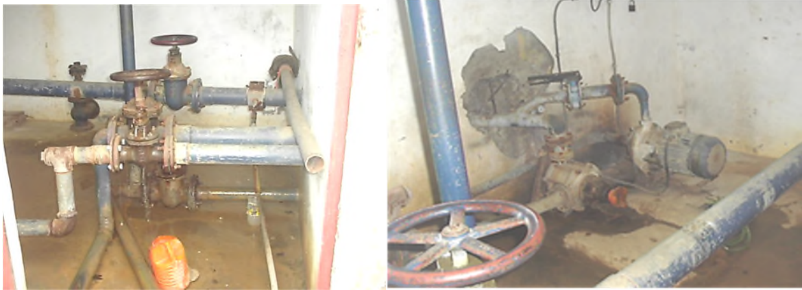
Figure.II.7 : Dégradation de l'état intérieur de la station de pompage du réservoir 150m 3 .
