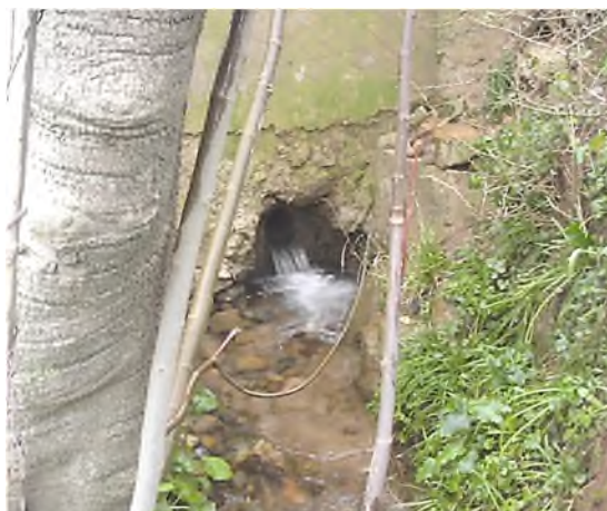
Figure.II.4 : L'ouverture du trop-plein du dans le captage
