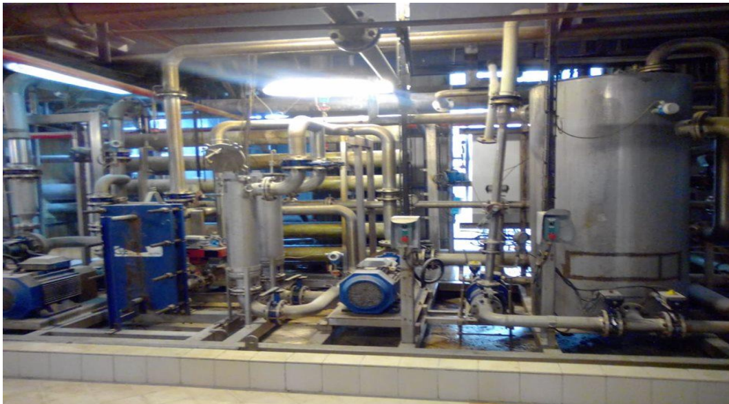
Figure III.1: Présentation de la station de nano filtration
