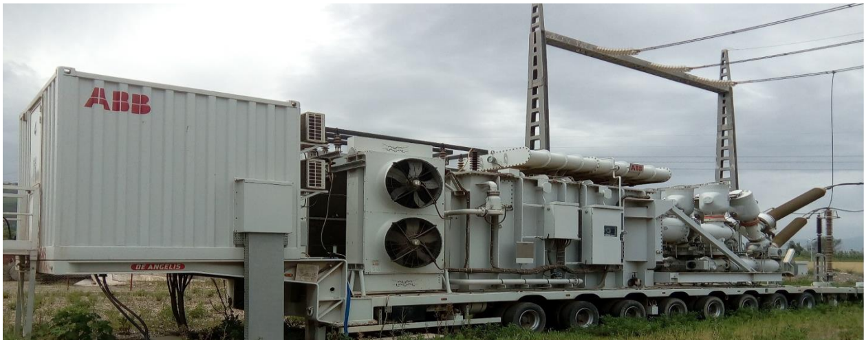
Figure I.5 : Transformateur ABB d'AMIZOUR
