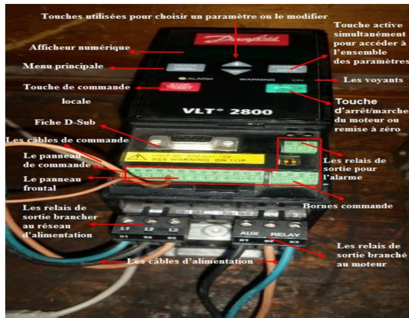
Figure III.3 : Composante et câblage électrique du variateur de vitesse DANFOSS VLT -2800.
