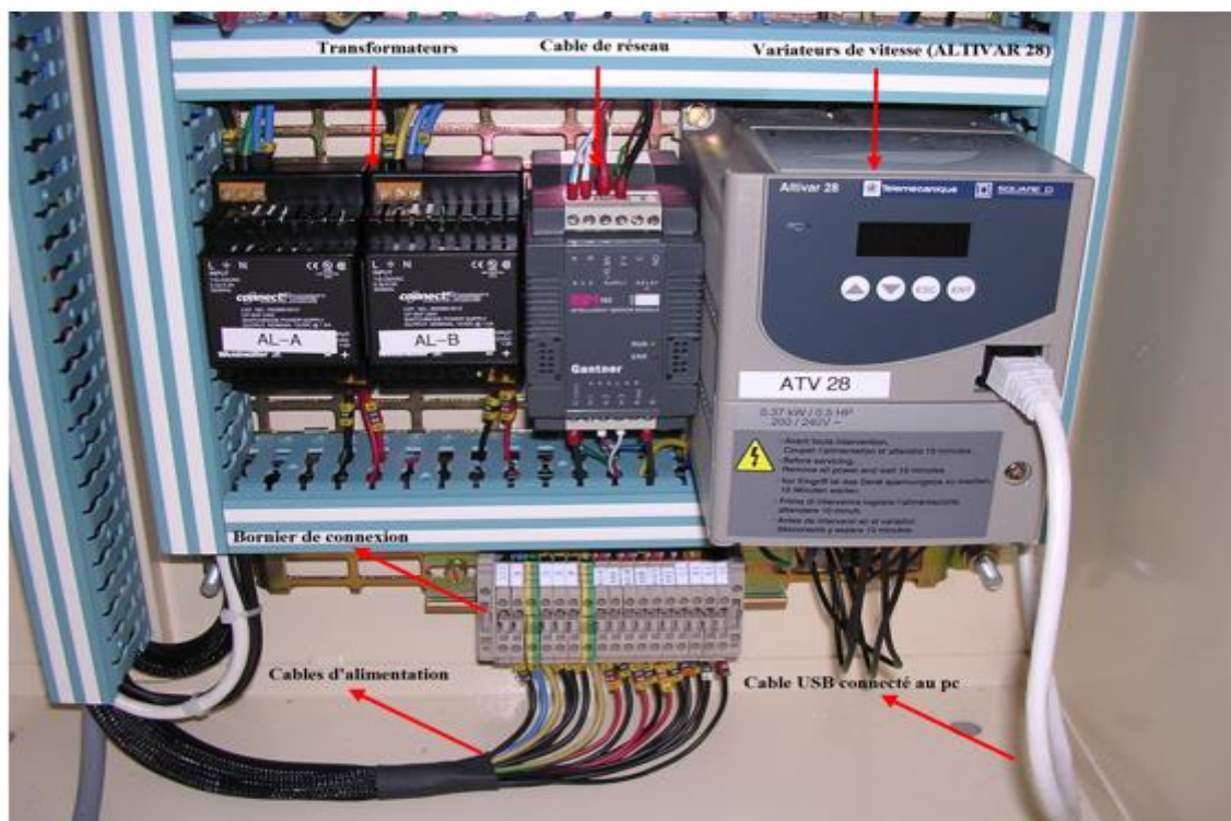
Figure III.1 : Armoire électrique dotée du variateur ALTIVAR 28.
