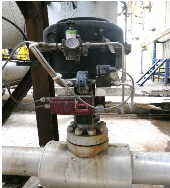
Figure I.9 : Vanne de régulation.
