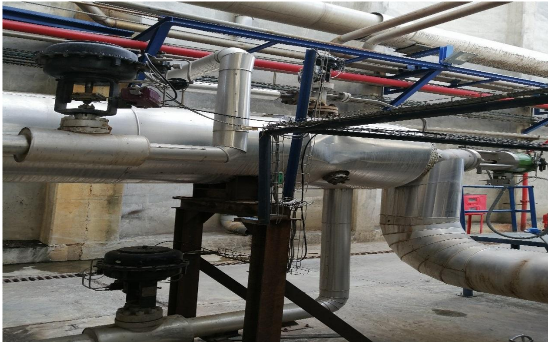
Figure II.2 : système détente désurchauffe de la vapeur de CEVITAL.
