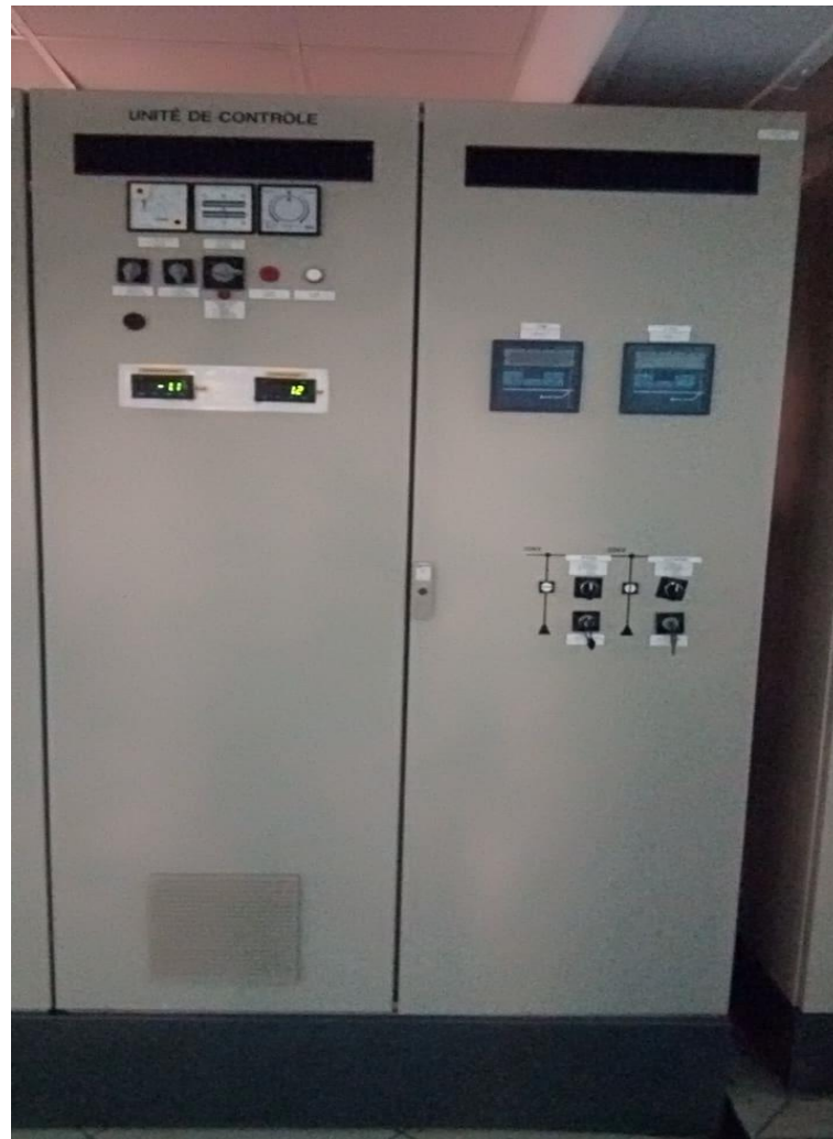
Figure1.12 : L'armoire de commande SEG
