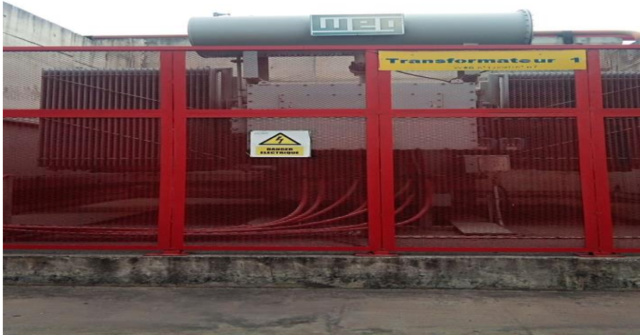
Figure1.4 : Transformateur T01 11/30kV
