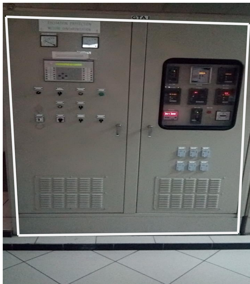
Figure1.11 : Armoire de synchronisation
