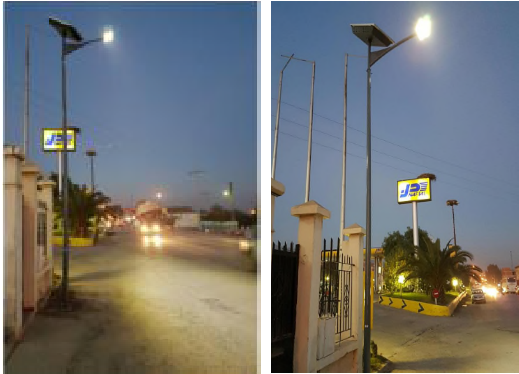
FigureIV.1 : Éclairage public solaire à LED (installation W. Béjaïa, Juillet 2016). [1]
