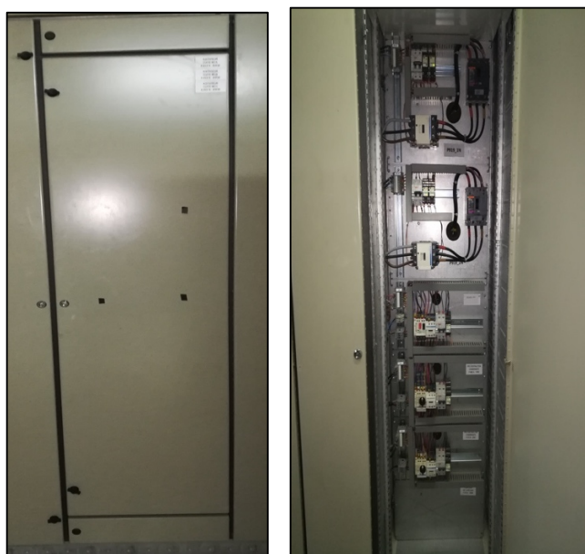
Figure III.1. Colonne électrique au sein de la raffinerie
