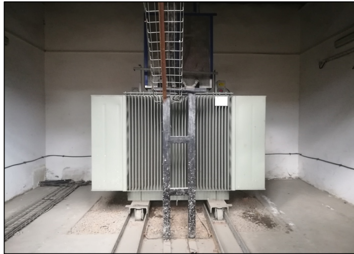
Figure II.13. Transformateur abaisseur de tension 30kV/400V de la raffinerie sucre CEVITAL
