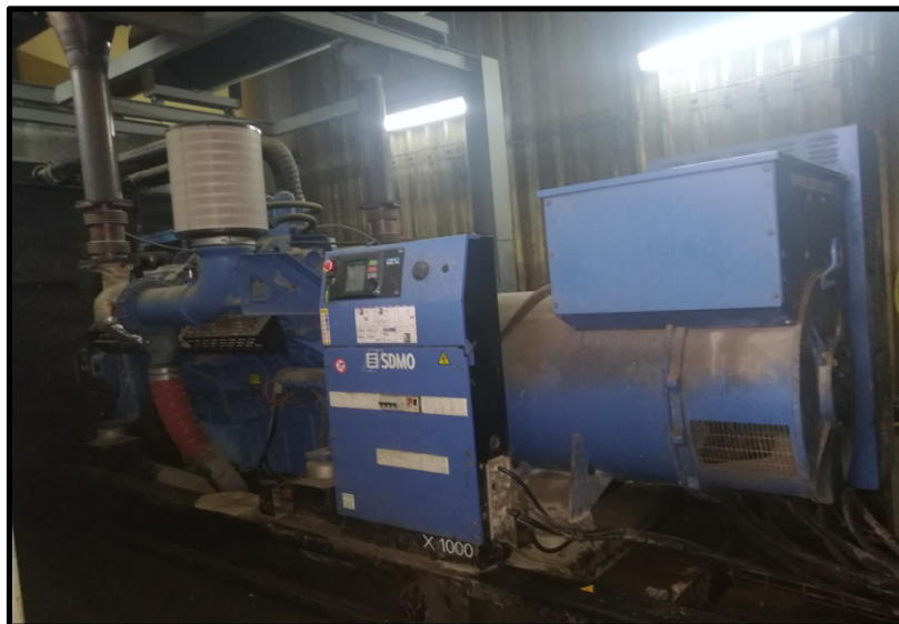
Figure II.16. Groupe électrogène de la raffinerie sucre CEVITAL
