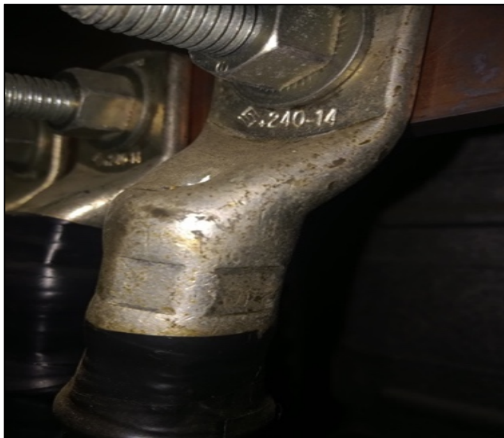
Figure IV.3. Image réel représentant le câble utilisé pour l'alimentation du GE
