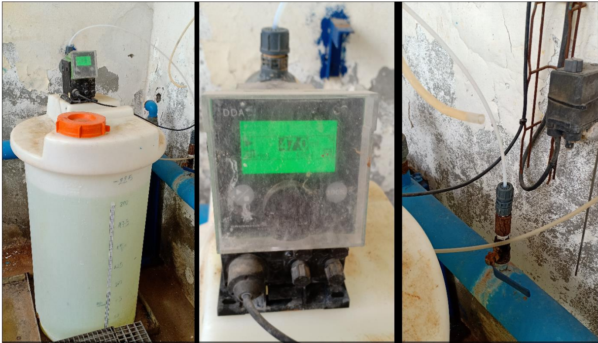
Figure (II.2) : Photo du mécanisme de traitement par eau de javel
