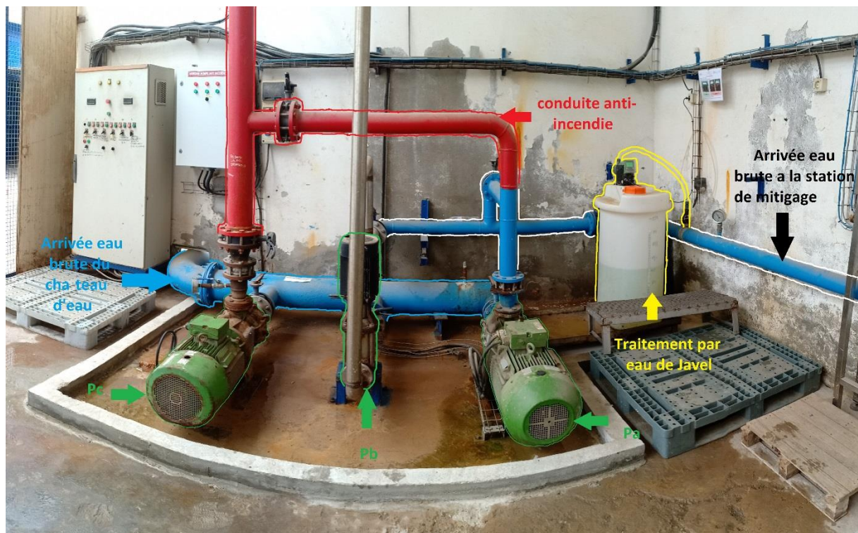
Figure (II.1) : Photo de l'arrivée de l'eau brute à la station
