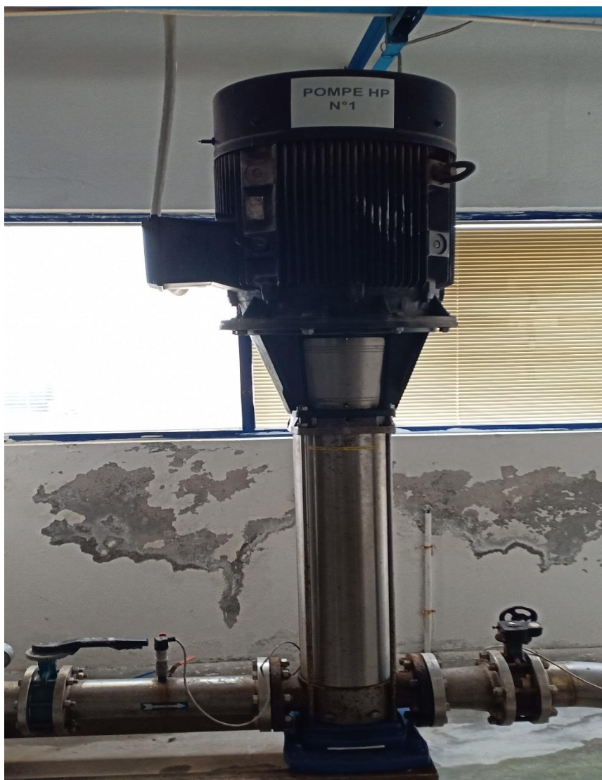
Figure (I.6) : Photos de la pompe HP du 1er étage de l'osmoseur inverse.
