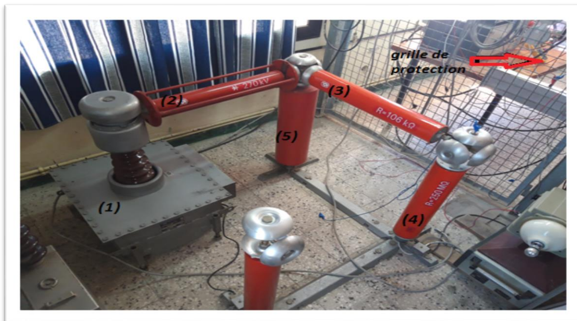
Figure II.8 Installation haute tension utilisée au laboratoire de Bejaia
