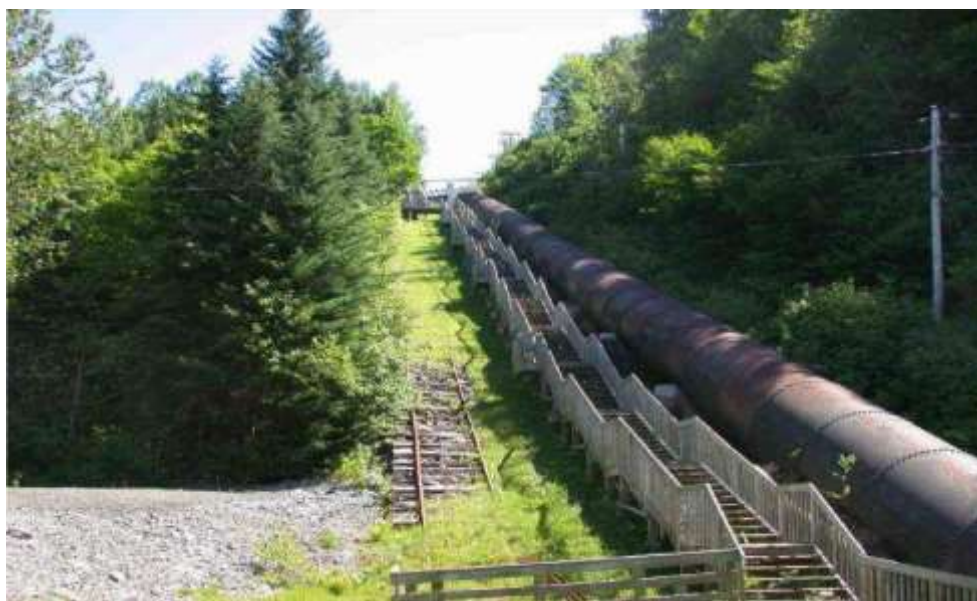
Figure I.9 : Exemple de conduite forcée aérienne
