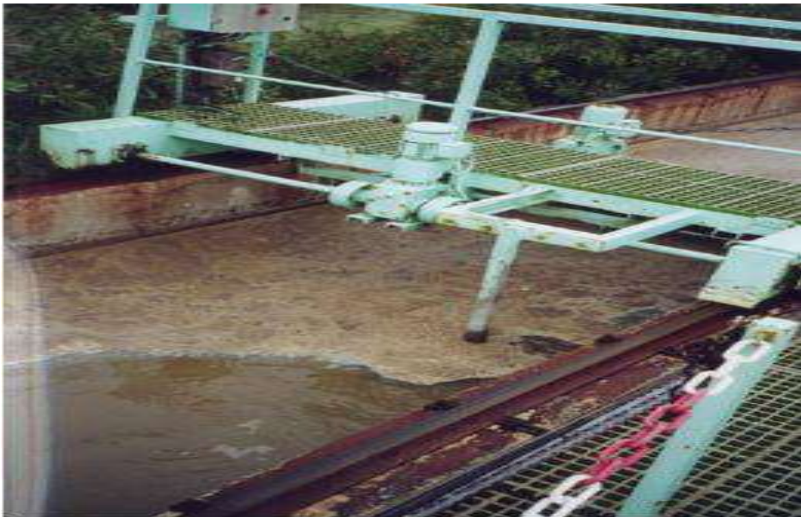
Figure I.7. Photo d'un déshuileur utilisé dans l'épuration des eaux usées [32].
