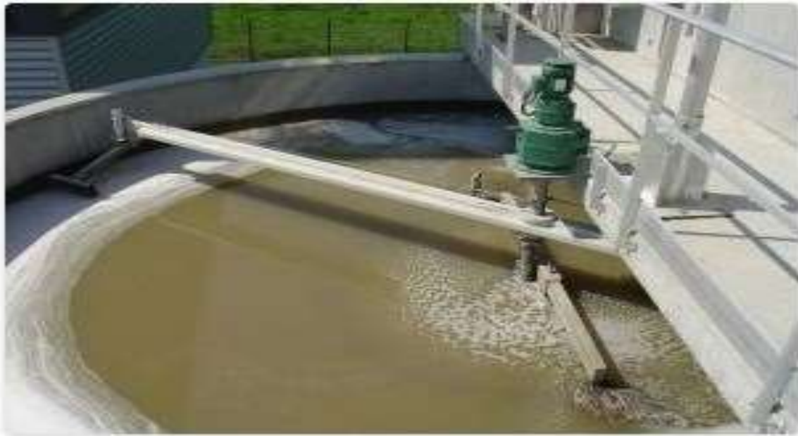
Figure I.6. Photo d'un dessableur [30].
