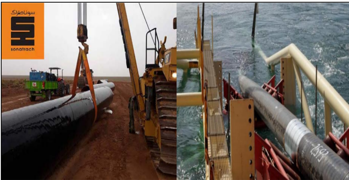
Figure I.1: On montre le pipeline reliant Hassi_Mesaoud à Almeiria [1]
