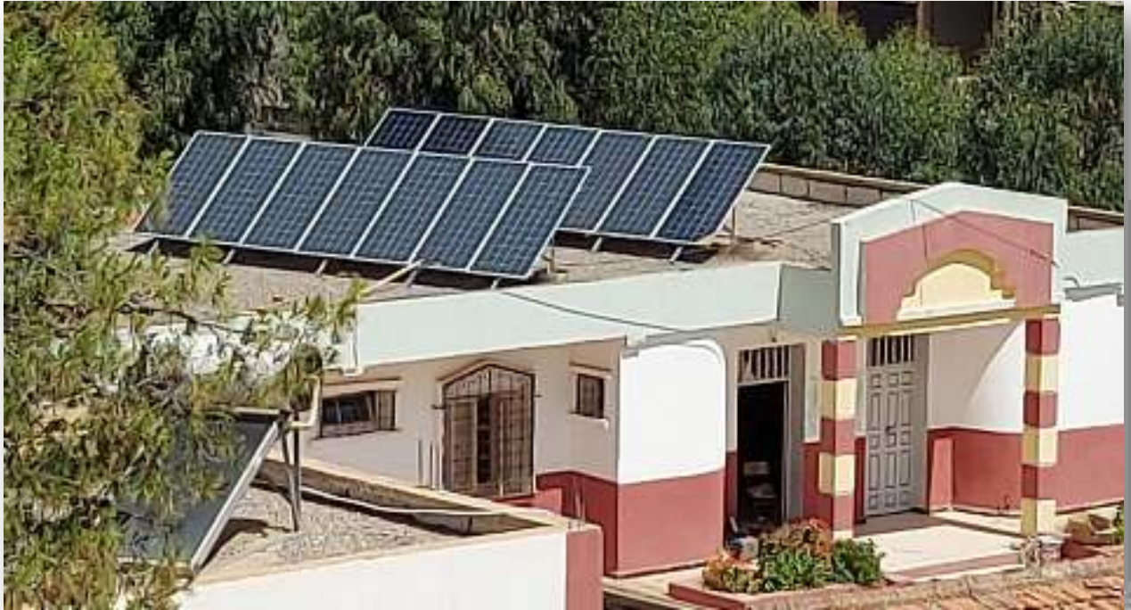
Figure.III.24 : Toiture avec les panneaux photovoltaïques installés
