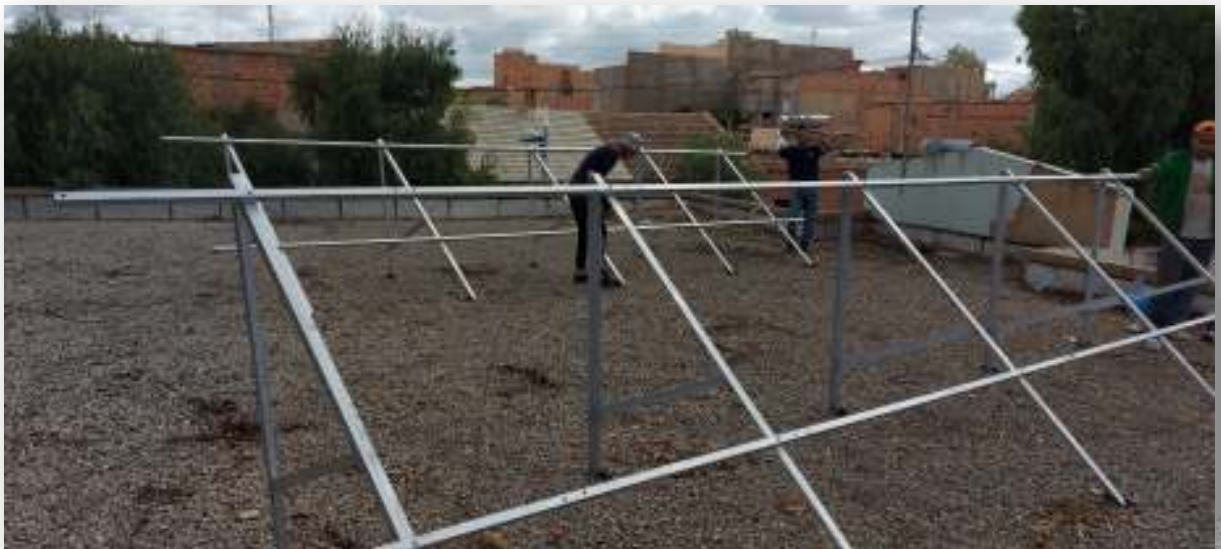
Figure.III.3 : Structure porteuse des modules photovoltaïques
