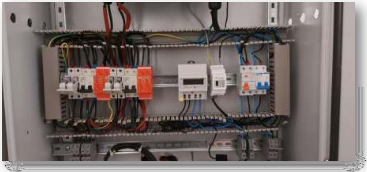
Figure.III.21 : câblage des différents éléments de l'armoire
