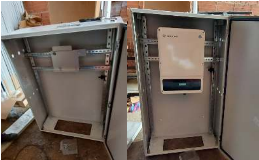
Figure. III.9 : Structure pour l'onduleur Figure. III.10 : Montage de l'onduleur sur la structure
