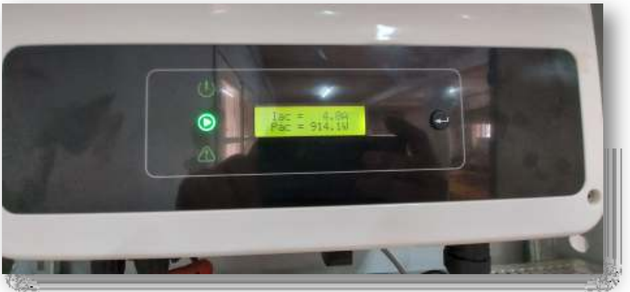
Figure.III.25 : Onduleur en plein fonctionnement
