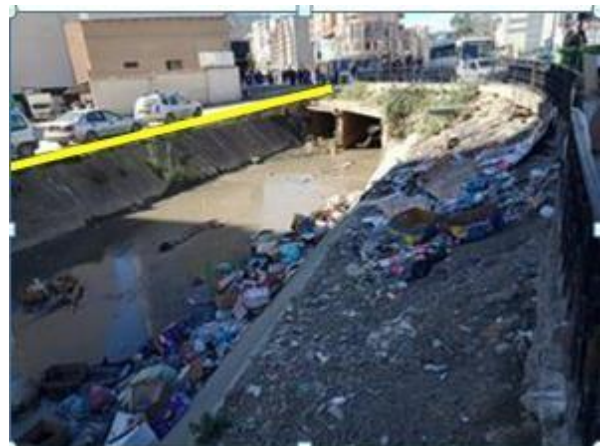
Figure 67: Oued Sghir et leur état actuel, Source : Auteurs
