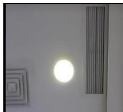
Figure 45 : chauffage centrale Source : photo prise par auteur 02/06/21
