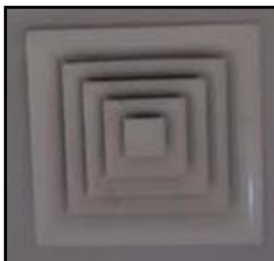
Figure 46: ventilation artificielle Source : photo prise par auteur 02/06/21
