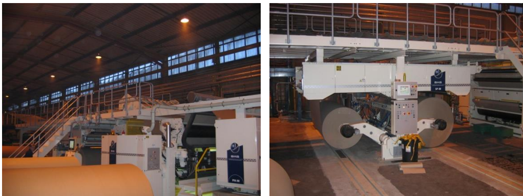
Figure N°2.5: Onduleuse 4 nouvelle simple face.
